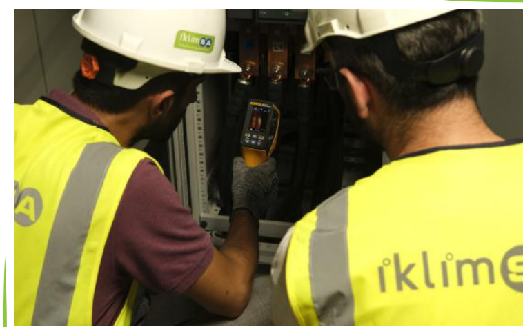
Termal Kamera ile Bağlantı Kontrolleri
