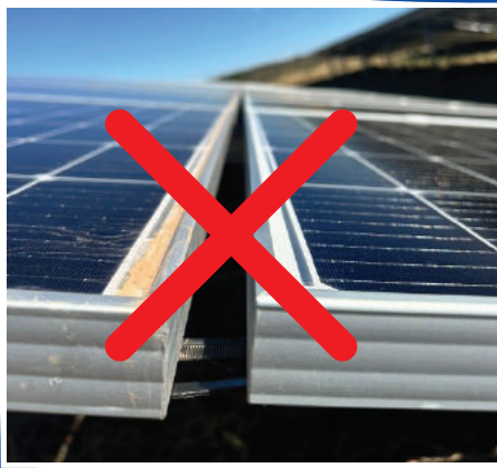
*Klempelerin tork kontrolleri yapılmadığı için paneller arası boşluk mesafesi artmış durumdadır.
