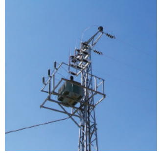
Resim 12: Direk tipi trafo
